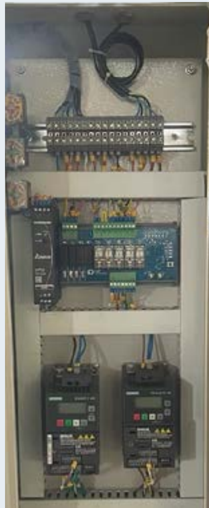
تابلو با مینی کنترلر ESP
