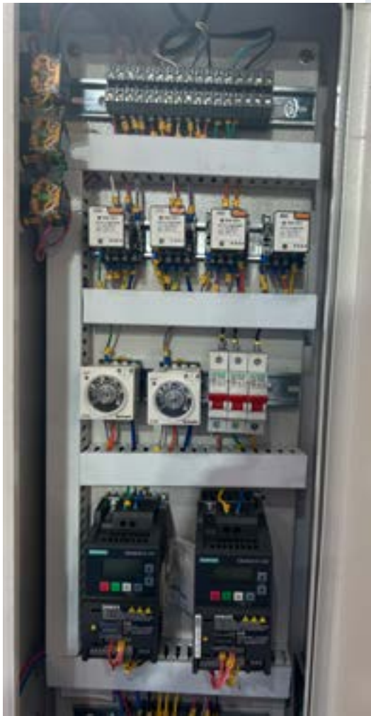
تابلوی کنترل رایج
